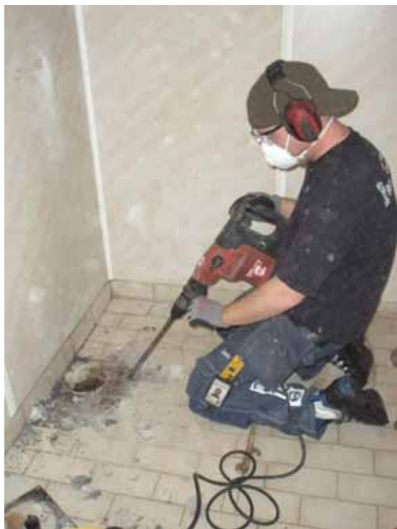
Bilning medför kraftig dammbildning.
